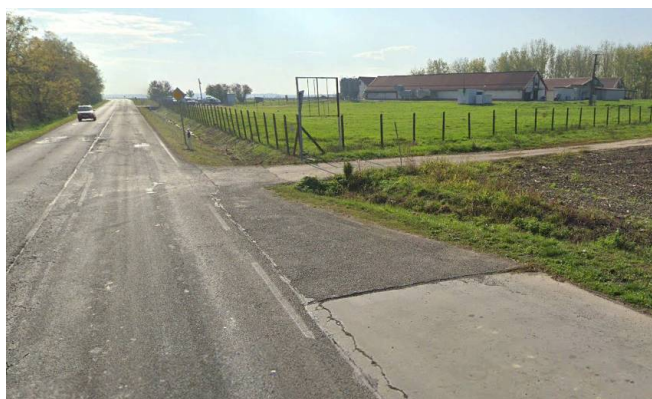
Föld út csatlakozás
